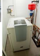
Pompe à chaleur
