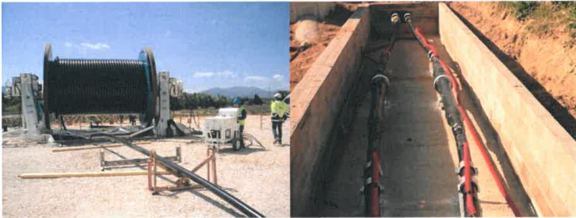
Figure 8 : Touret de câbles et chambre de jonction
